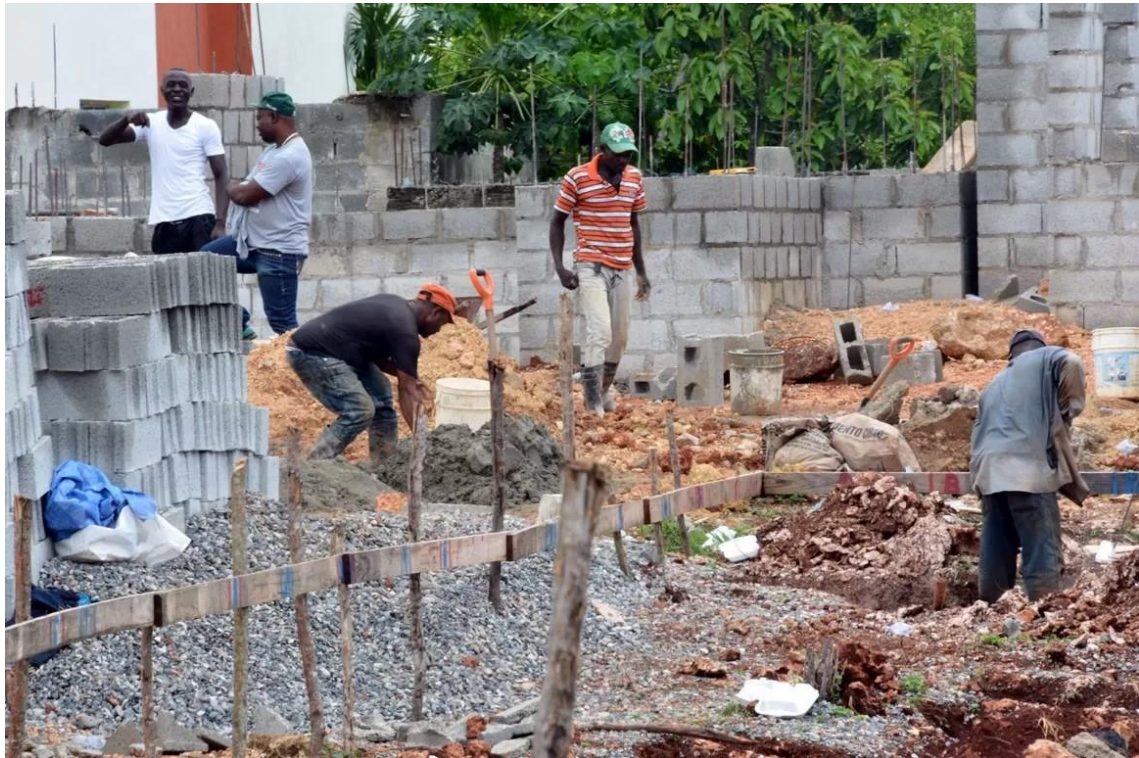
Construcción sin señalización ni protección en muros: ilustración de riesgos estructurales en zonas sin resguardo ni protocolo.
